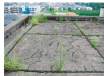
写真No.11 植物の繁茂: 伸縮目地部に植物が根を張り繁殖している。
